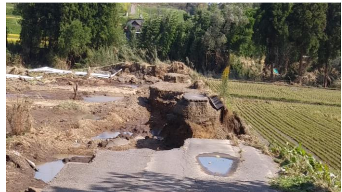
濁流にえぐりとられた農道
